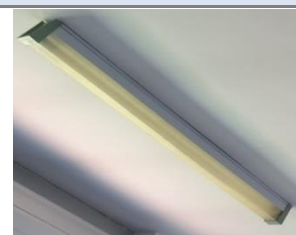
Figura 6 - Corpi illuminanti da sostituire
